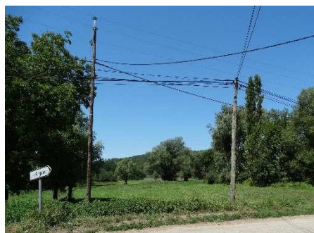
Réseaux aériens en surnombre
