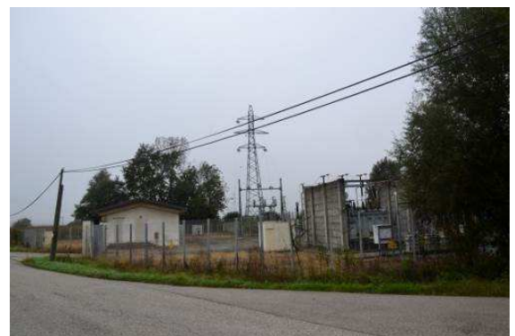
transformateur au nord des Bernards à Yenne
