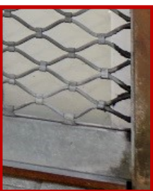
10. Grille de protection disposée en extérieur
