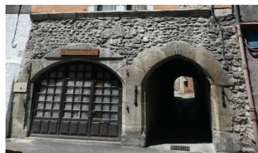
Baies en arcade fermées par menuiseries à petit bois posées en feuillure
