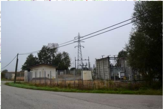
transformateur au nord des Bernards à Yenne
